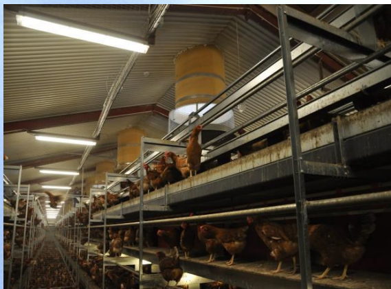
Mekanisk ventilation som ligetryk
